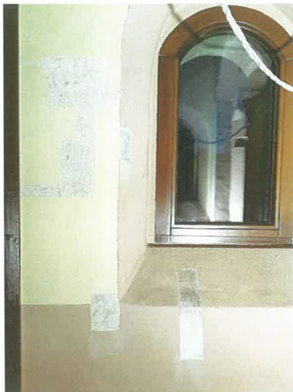
Fot. 25. Odkrywki wykonane w kruchcie. Widoczna jasnokremowa oryginalna warstwa malarska.
