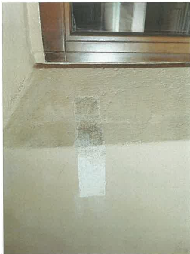
Fot. 26. Odkrywki wykonane w kruchcie. Widoczna jasnokremowa oryginalna warstwa malarska.
