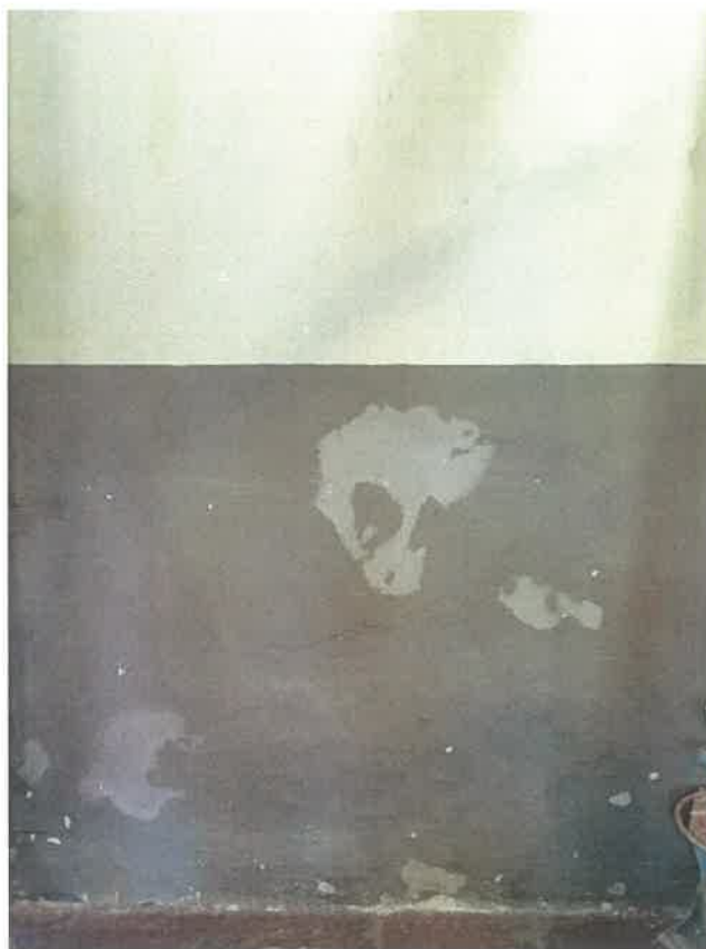
Fot. 3. Ściana północna. Widoczny zły stan zachowania lamperii. Obecna kolorystyka ścian.
