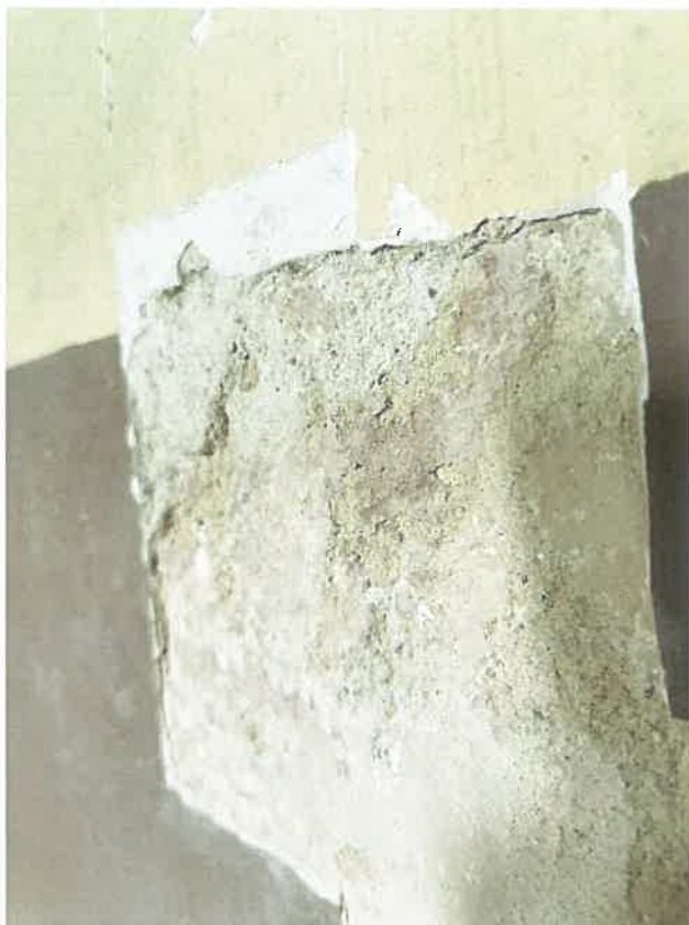
Fot. 7. Ściana północna. Odkrywai ukazujące pierwotną jasnobrązową warstwę malarską.
